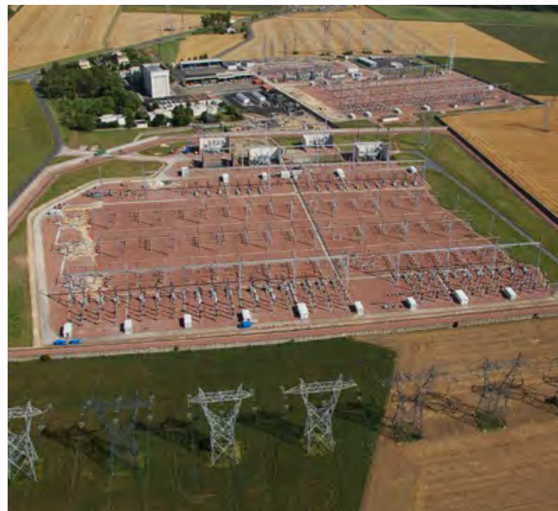
Poste électrique de Distré près de Saumur (49)
