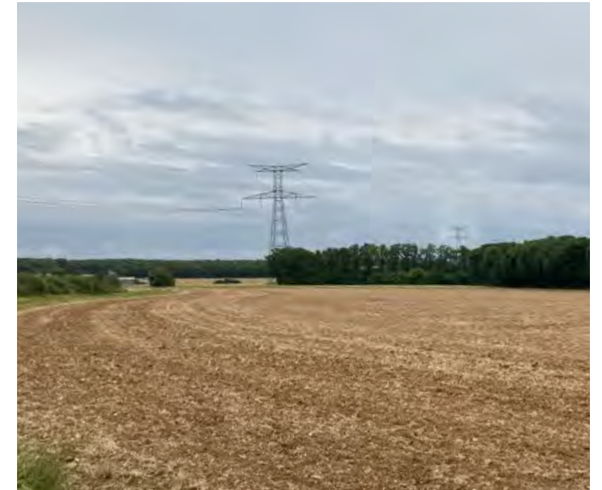
Ligne 400 000 volts existante entre les postes de BRAUD et GRANZAY.
