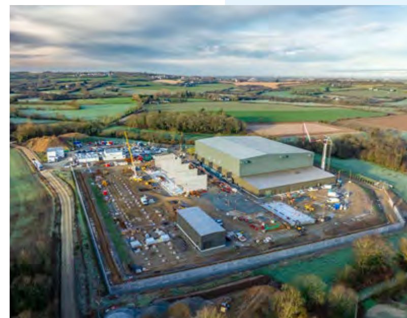
Station de conversion de l'interconnexion avec L'Irlande : Celtic interconnector.
