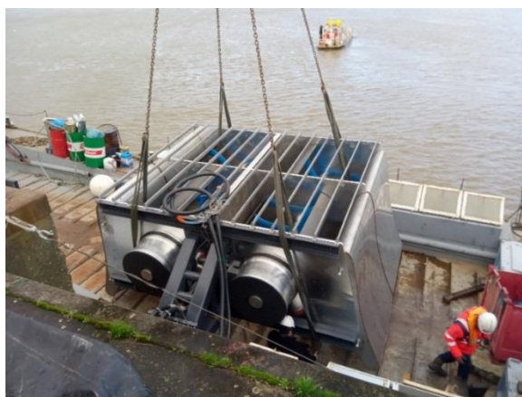
Montage de l'hydrolienne estuarienne sur la plateforme d'essai Seeneoh à Bordeaux en janvier 2018
